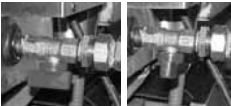
Llave de paso de gas "on" (abierta)
